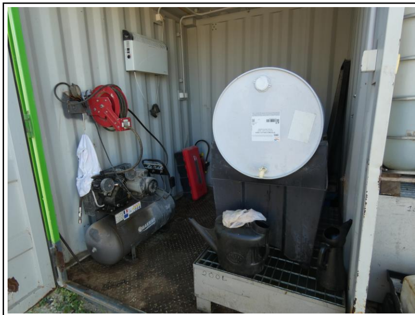
Stockage du fût d'huiles neuves sur rétention étanche, à l'intérieur d'un local technique (septembre 2023).
